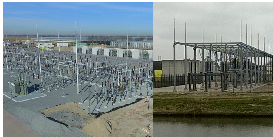
Referentiebeelden: installatiegebouwen met open structuur ( bron beeld links: Roxtec.com)
