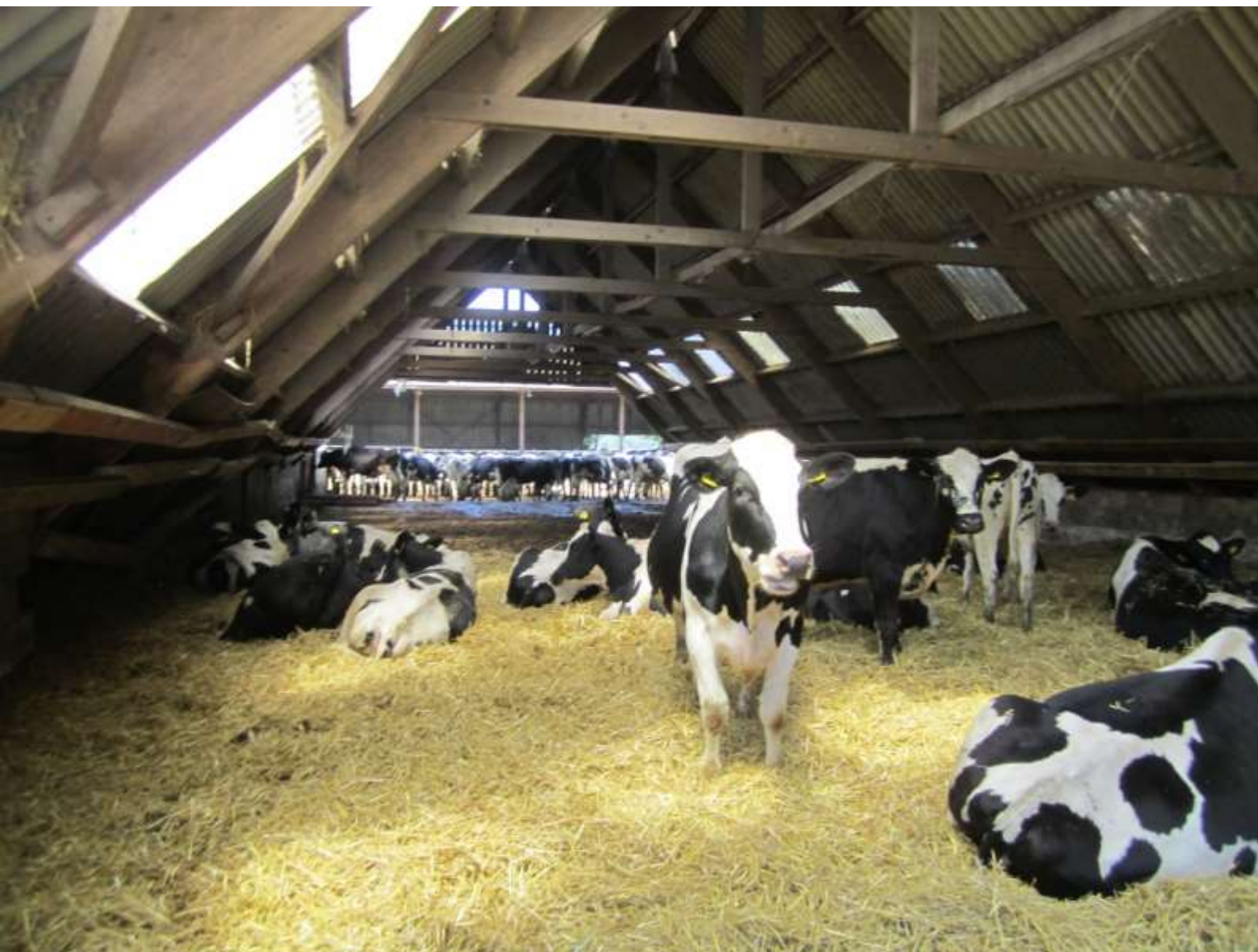
Foto 5. Af te breken stal met asbestdak.
