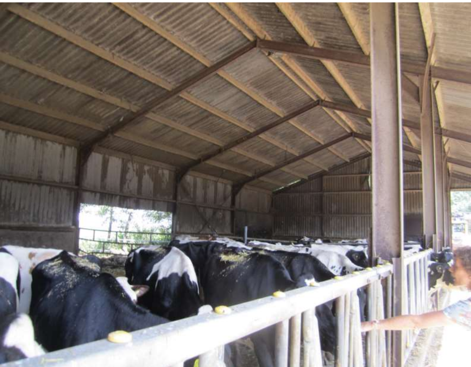
Foto 4. Af te breken stal met asbestdak.
