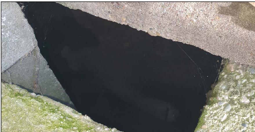
Figuur: alle aanwezige kelders of kruipruimtes stonden onder water en kunnen daarom niet in gebruik zijn door steenmarter.
