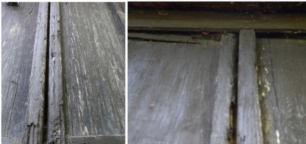
Figuur 5. Openingen in het schuurschot geschikt als zomer- of paarverblijfplaats van vleermuizen
