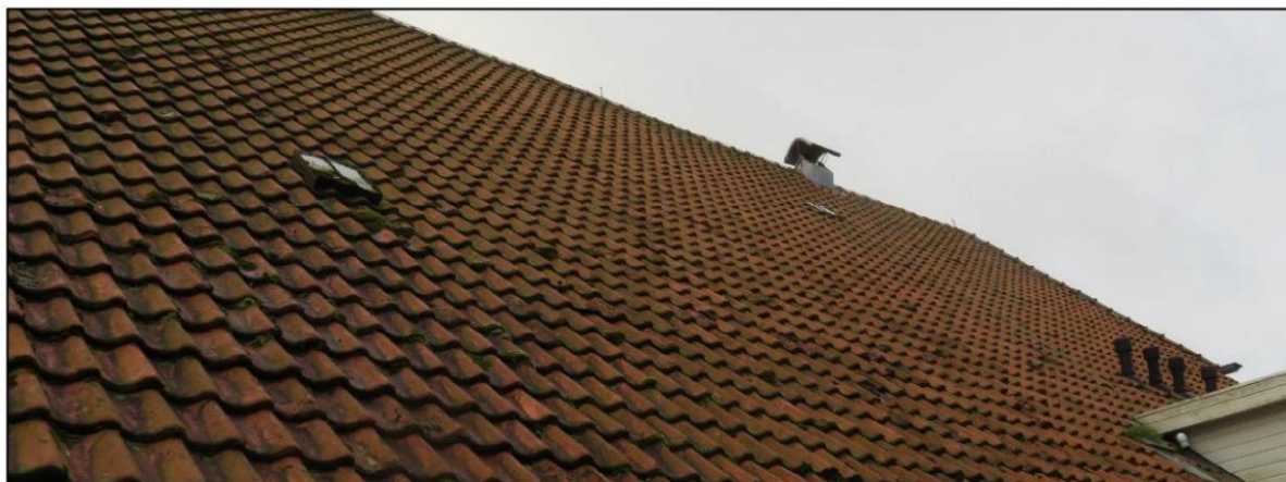
Afb 12: Pannen liggen strak en zonder schade, waardoor geen mogelijkheden om in- en uit te vliegen
