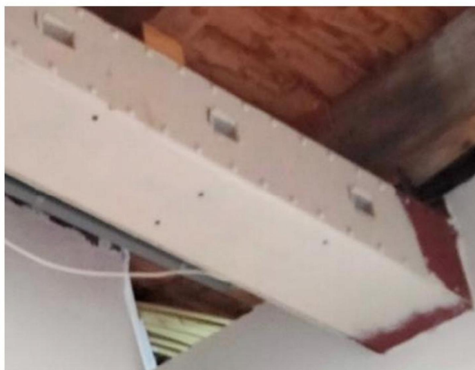
Afb. 40, het ondervlak van de balk was de windzijde van de roede.
