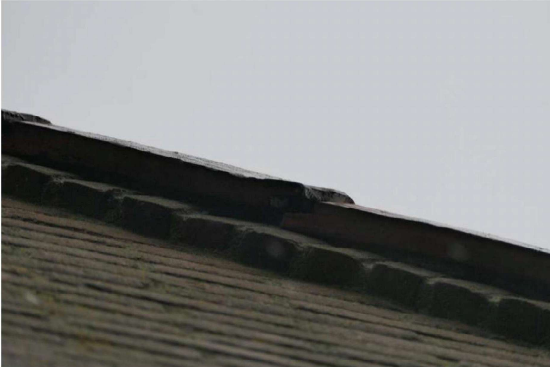
Figuur 4.3 De kantpannen van de woningen sluiten strak aan op de gevels en bieden geen toegang voor gierzwaluwen en vleermuizen.
