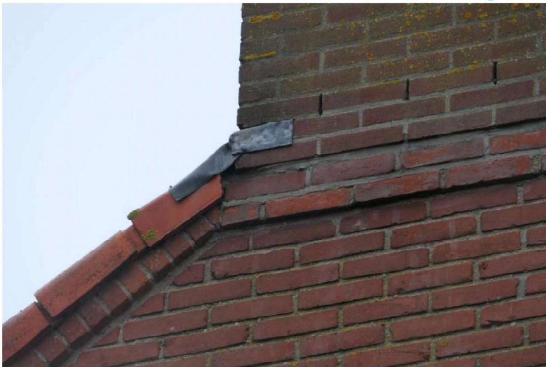
Figuur 4.6 Onder de loodslab bij de kopgevel van Laan Bloys van Treslong 56 is een opening aanwezig die toegang biedt tot de daklaag en/of spouw.
