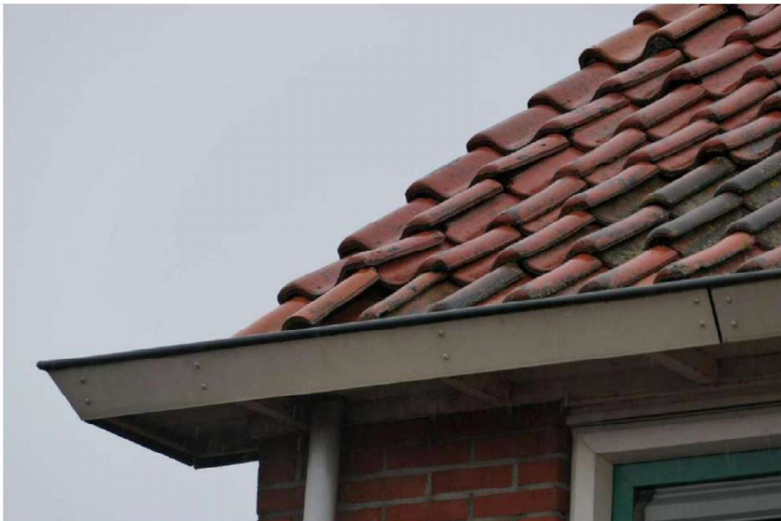
Figuur 4.2 Bij de woning Laan Bloys van Treslong 5 is een losliggende dakpan aanwezig die voor huismussen mogelijk toegang biedt tot de daklaag.
