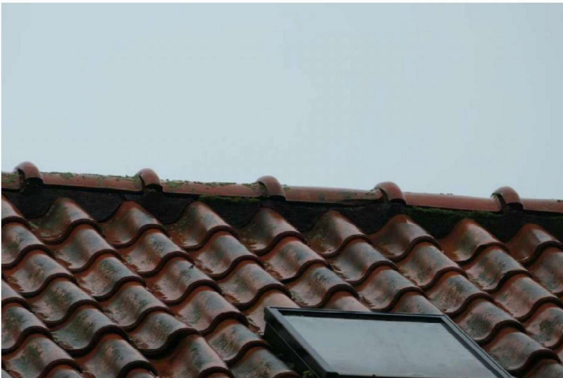
Figuur 4.4 De nokpannen van de woningen zijn dichtgemetseld.
