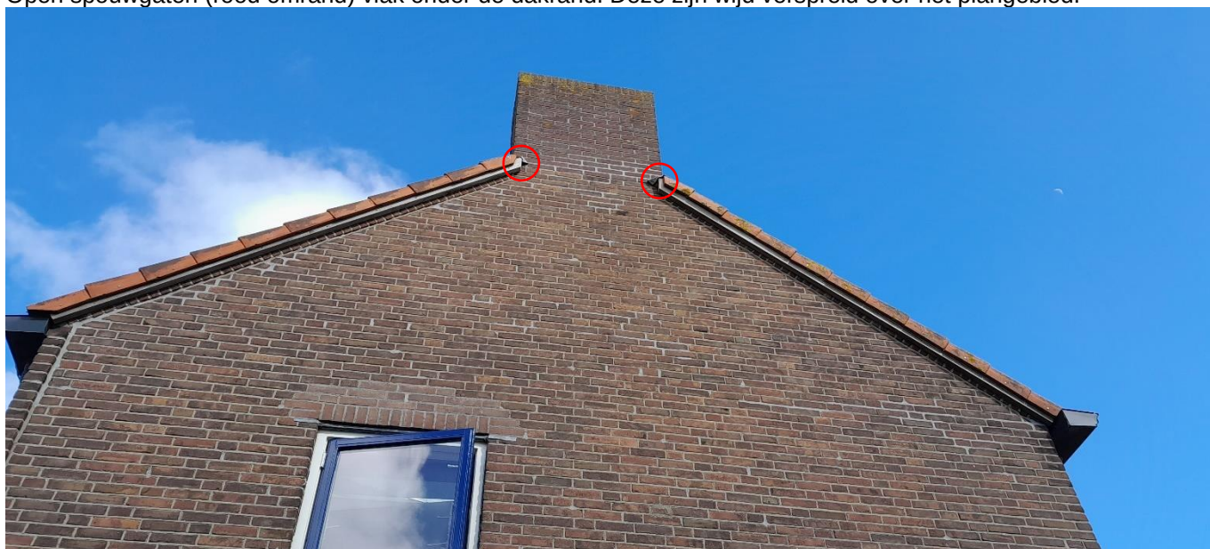
Overhangende dakpannen aan de kapse kant van de rijtjes huizen. Hier bevinden zich spleten/gaten waar vleermuizen in kunnen kruipen. De loszittende loodflappen (rood omrand) zijn voorbeelden waar gierzwaluwen in kunnen vliegen.
