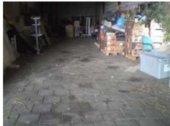
Olievlekken op de tegels in de loods, rechts van de wasstraat
