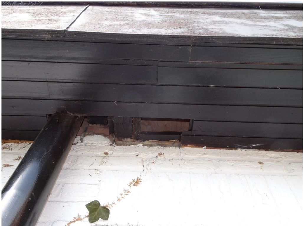
Een aangetroffen gat in de daklijst aan de achterzijde van het winkelpand.
