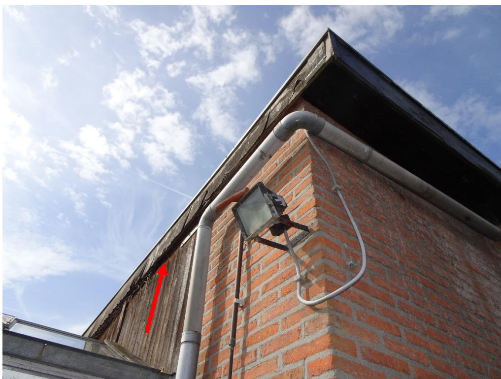
Potentiële verblijfplaats achter het boeibord aan de achterzijde van het winkelpand.
