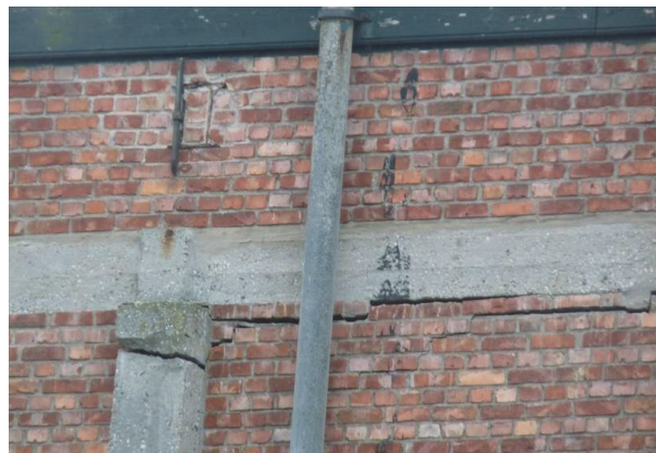
Fig. 12. Detail van de muur op fig. 11, met scheur in de muur, groot genoeg voor vleermuizen.
