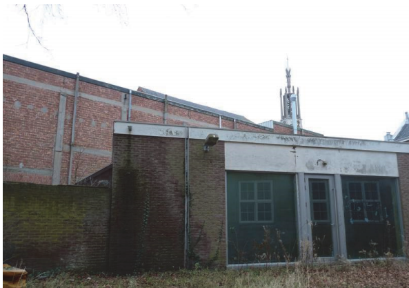
Fig. 11. Muur van een van de gebouwen van de bioscoop. Boven de regenpijp rechts zit een scheur in de muur (zie ook fig. 12).
