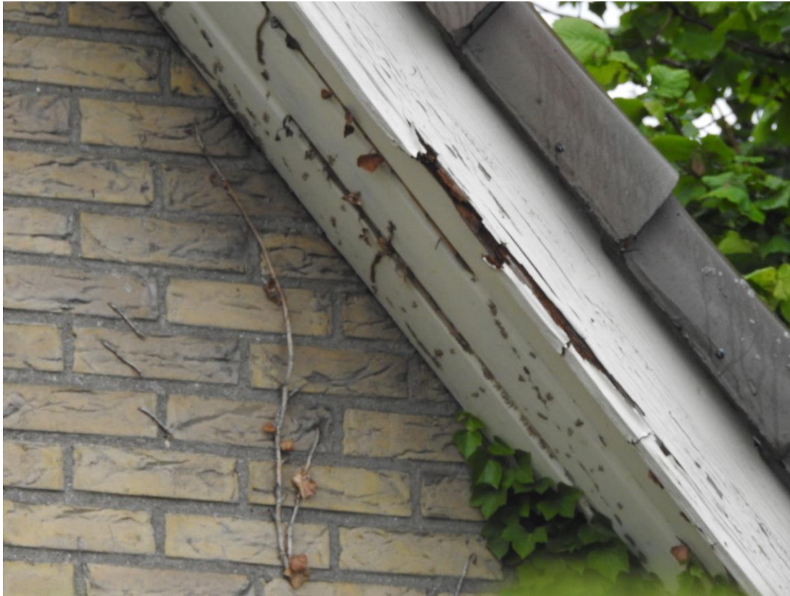
Foto 5. Openingen daklijsten woonhuis.
