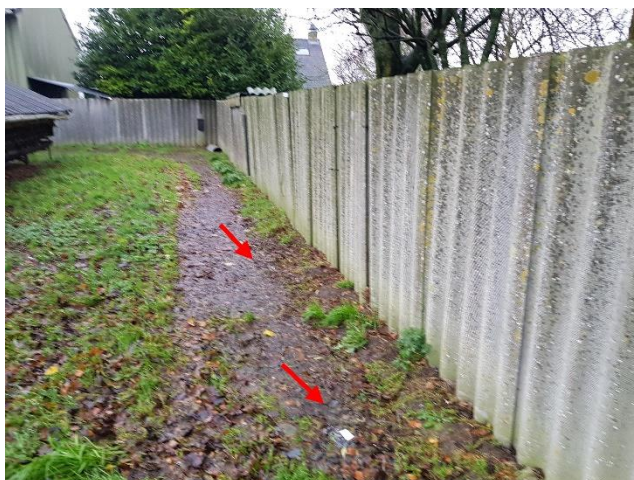
Foto 68 | Foto voor bron Golfplaat (verontreiniging)
