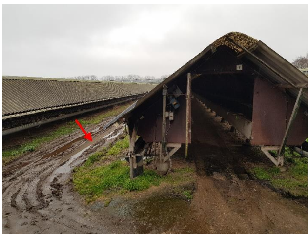
Foto 62 | Foto voor bron Golfplaat (verontreiniging)
