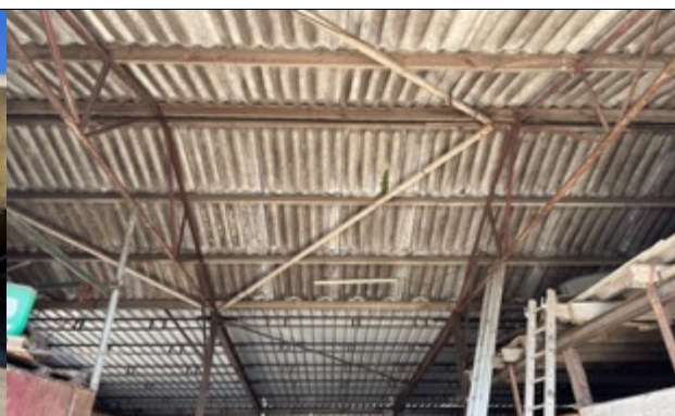
Foto 18: Onderzijde dak schuur 4 niet geïsoleerd
