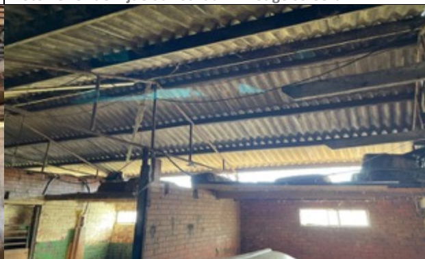
Foto 20: Onderzijde dak schuur 4 niet geïsoleerd
