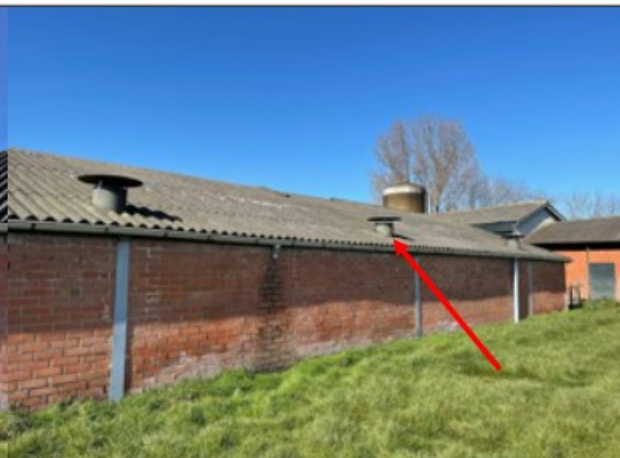
Foto 2: Ventilatiekappen dak schuur 3
