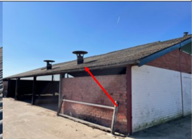
Foto 2: Ventilatiekappen dak schuur 2
