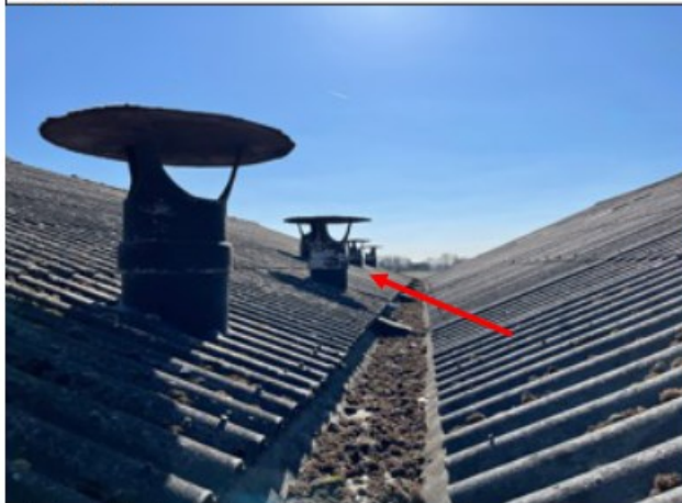
Foto 1: Ventilatiekappen dak schuur 2
