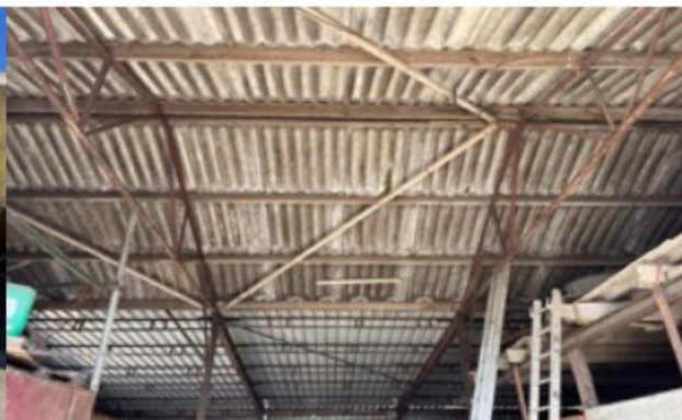
Foto 18: Onderzijde dak schuur 4 niet geïsoleerd
