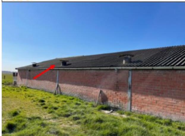
Foto 1: Ventilatiekappen dak schuur 3
