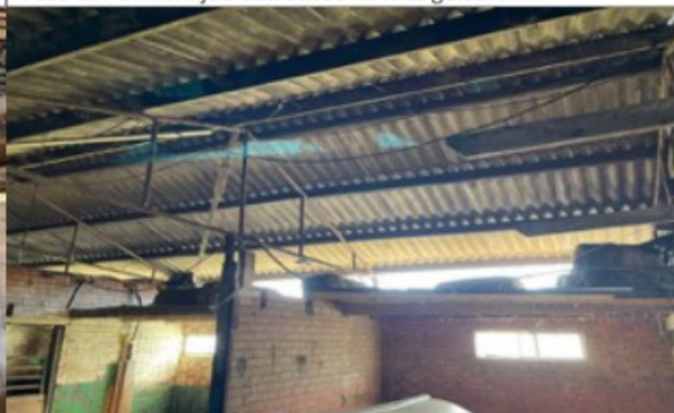
Foto 20: Onderzijde dak schuur 4 niet geïsoleerd
