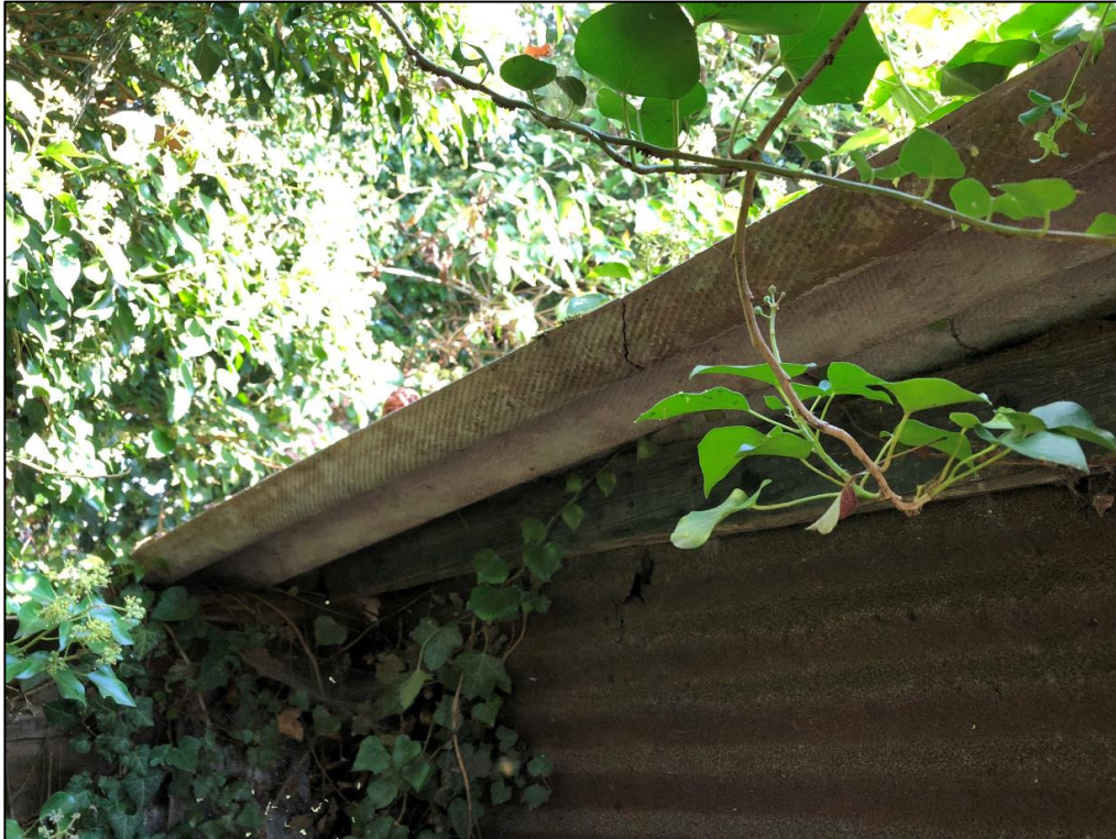
Foto 14: Achterzijde (noordkant) vervallen schuurtje. Datum foto: 16 september 2020
