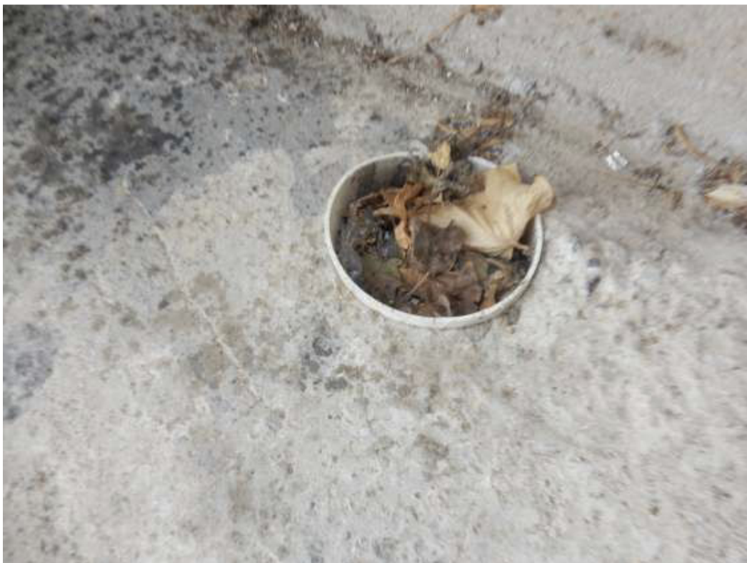
Foto 3 Riolering voormalige toilet: geen asbest aangetroffen
