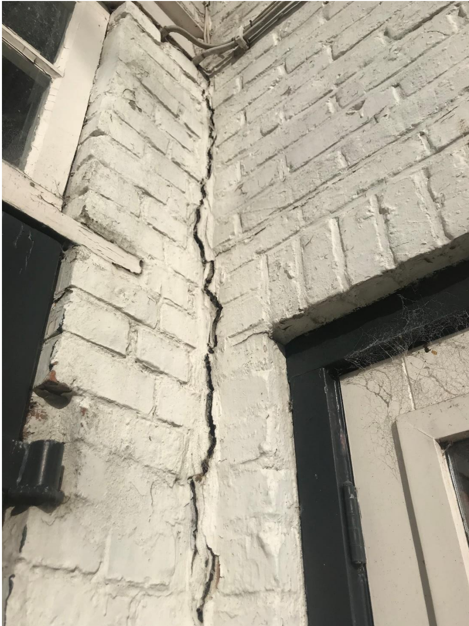
Figuur 5. Gevel Wilhelminastraat 20 Sint Jansteen bevat scheuren.
