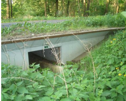
Figuur 3.3. Betonnen duiker met faunapassage voor kleine grondgebonden zoogdieren, reptielen en amfibieën
