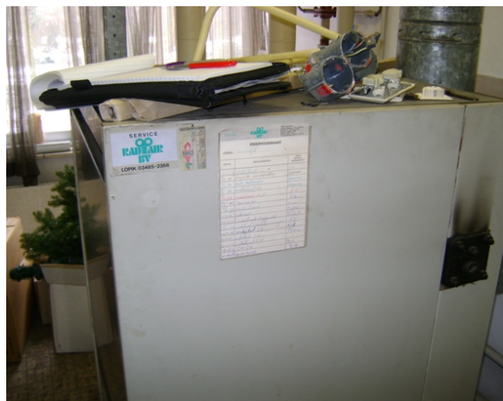
Foto 8: Kantoor, cv-ruimte: meerdere asbestbronnen aanwezig, zie AVH4, AVH5 en AVH6.
