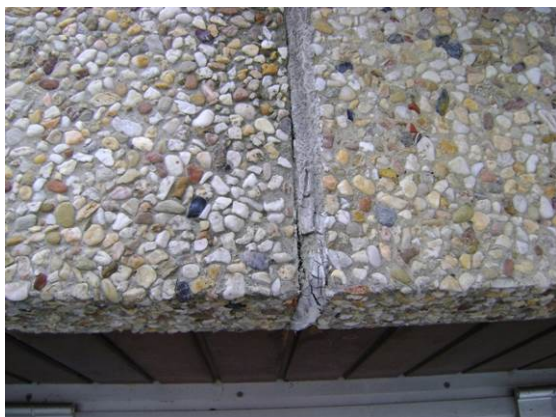
Foto 7: Kantoor, kit tussen de gevelelementen is als asbestvrij beoordeeld (zie M7 op analysecertificaat 10.25609-19).
