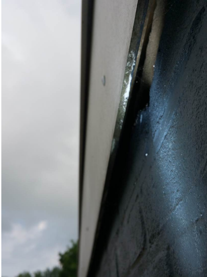
Figuur 2: Spleet tussen daklijst en muur aan zijgevel clubgebouw
