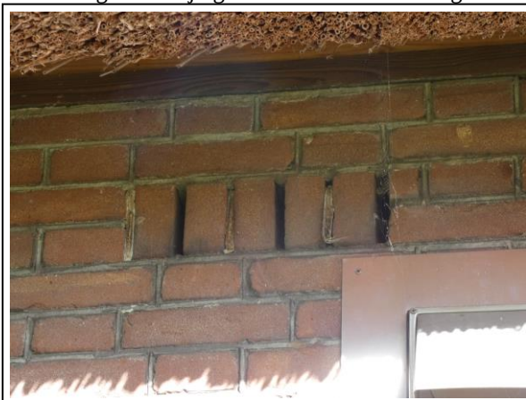
Foto 10 gedeeltelijk geïsoleerde ventilatievoegen
