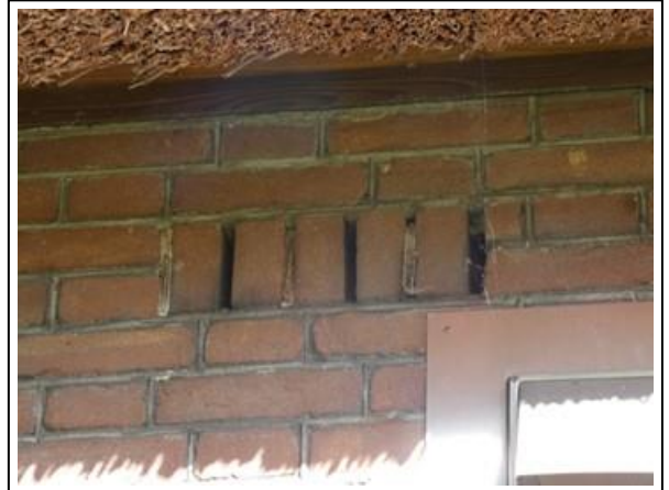
Foto 6 gedeeltelijk geïsoleerde ventilatievoegen
