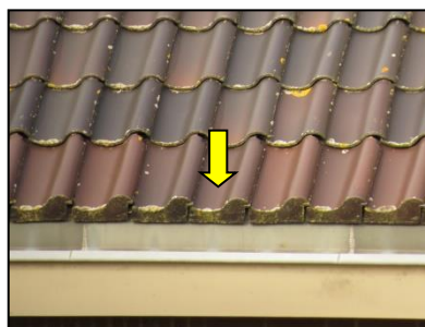
Figuur 15. Weinig toegankelijke dakgoot woonhuis nummer 14a.
