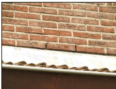
Figuur 20. Open stootvoegen in het woonhuis.
