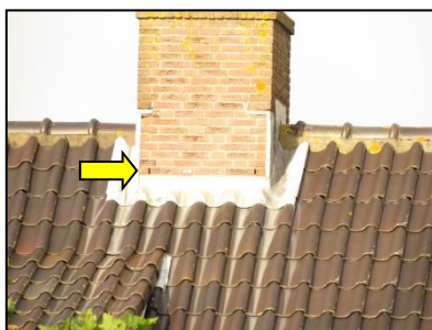
Figuur 14. Open stootvoegen in de schoorsteen van het woonhuis nummer 14a.
