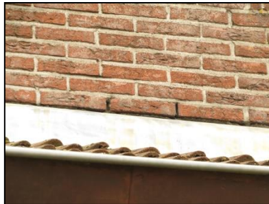
Figuur 20. Open stootvoegen in het woonhuis.
