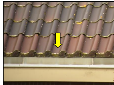
Figuur 15. Weinig toegankelijke dakgoot woonhuis nummer 14a.
