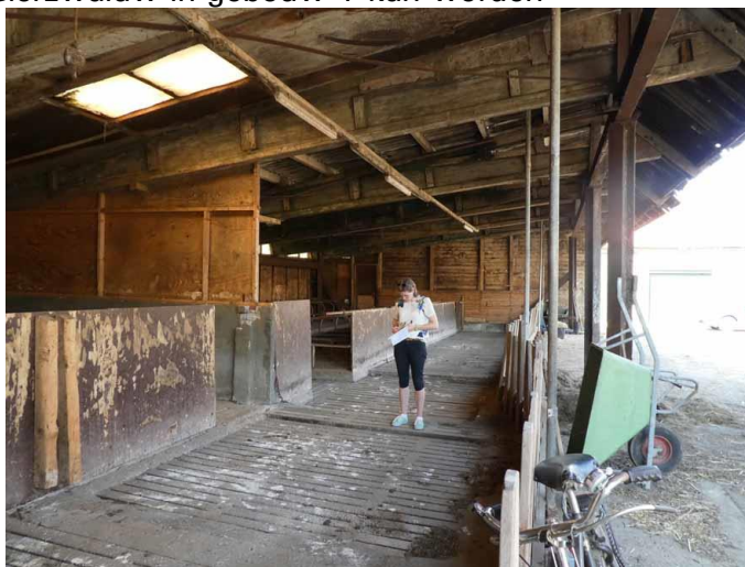
Figuur 7: Sporen van Kerkuil in gebouw 3
