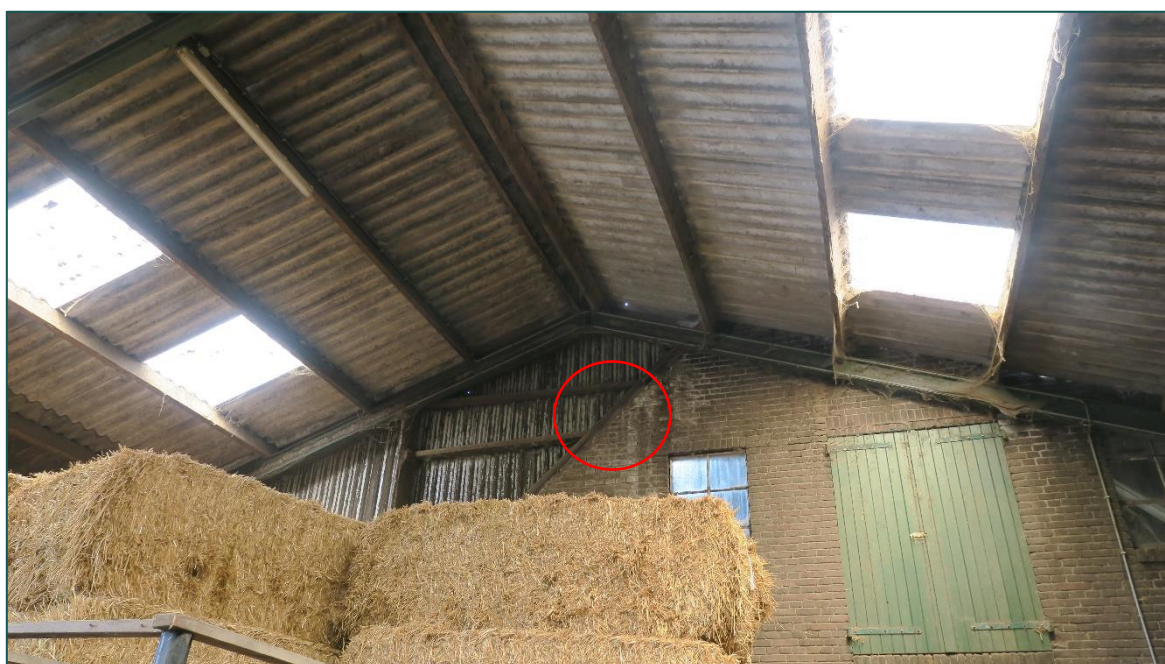
Figuur 3.4 De binnenkant van stal 8. De rode cirkel geeft aan waar het geblaas van de kerkuil het hardst te horen was en waar dus vermoedelijk een nestlocatie in de buurt is.
