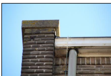
Figuur 9. Aaneengesloten dakgoot, geen aanwezige ruimte tussen de dakgoot en de gevel.
