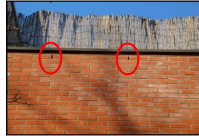
Figuur 16. Open stootvoegen (aangegeven met rode cirkels) aanwezig in het gebouw direct ten westen van de onderzoekslocatie.
