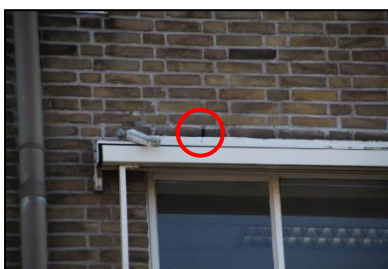
Figuur 11. Open stootvoeg (aangegeven met rode cirkel) aan de westelijke gevel van het hoofdgebouw, direct boven een kozijn.
