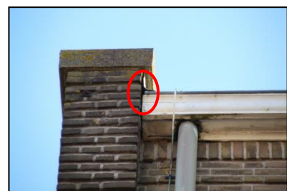
Figuur 13. Losliggende loodslab (aangegeven met rode cirkel) aan de westelijke gevel van het hoofdgebouw.
