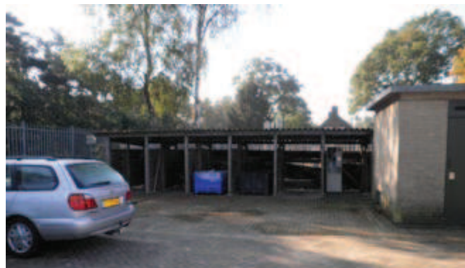
Foto 5 - Fietsenhok met asbest dakplaten
