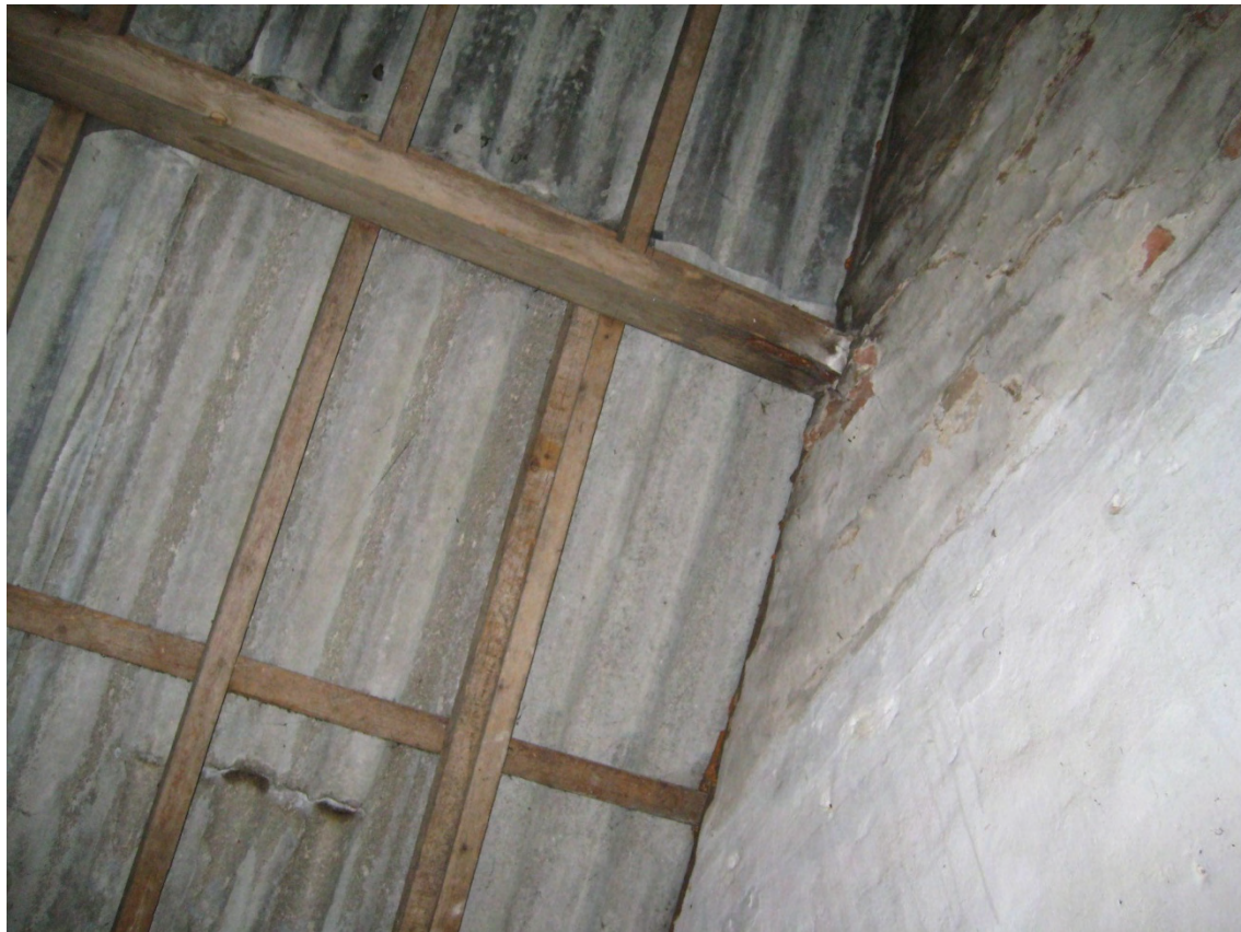
Inpandig aansluiting dakbedekking op gevel, geen dakbeschot
