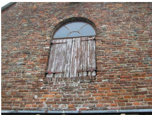
Fig. 10 Zolderluik met kieren in zuidgevel
