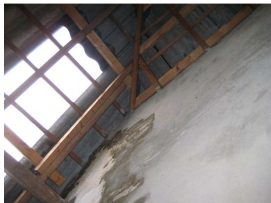
Fig. 11 Lichtinval dak, geen beschutte verblijfplaatsen
