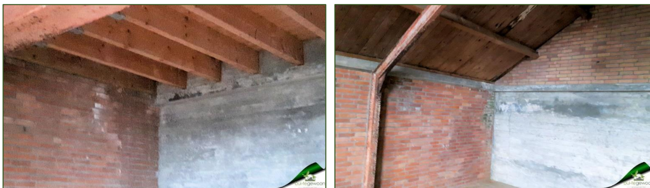
Figuur 7. Eerste verdieping plafond en muur (links), tweede verdieping (rechts)
