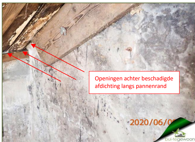
Figuur 2. Inpandige wand bij beschadigde afdichtingsrand
