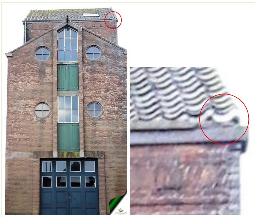
Figuur 1. Opening tussen daklijst en pannen
