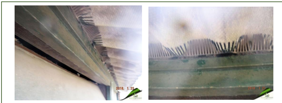
Figuur 5. Afdichting tussen muren en dakplaten met 'vogelschroot'
