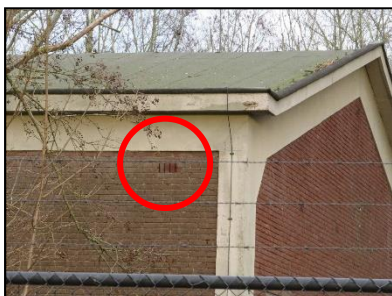
Figuur 17. Open stootvoegen bij de gebouwen op het (voormalig) militair terrein.
