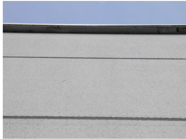
Figuur 7. Detailopname van de gevel van het bedrijfspand en de onderzijde van de metalen daklijst.
