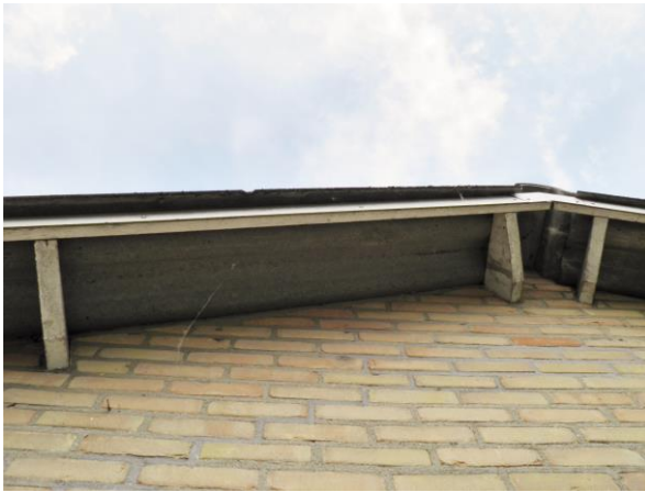
Figuur 6. Tussen de overstek en buitenmuur van de werkschuur is geen opening aanwezig.
