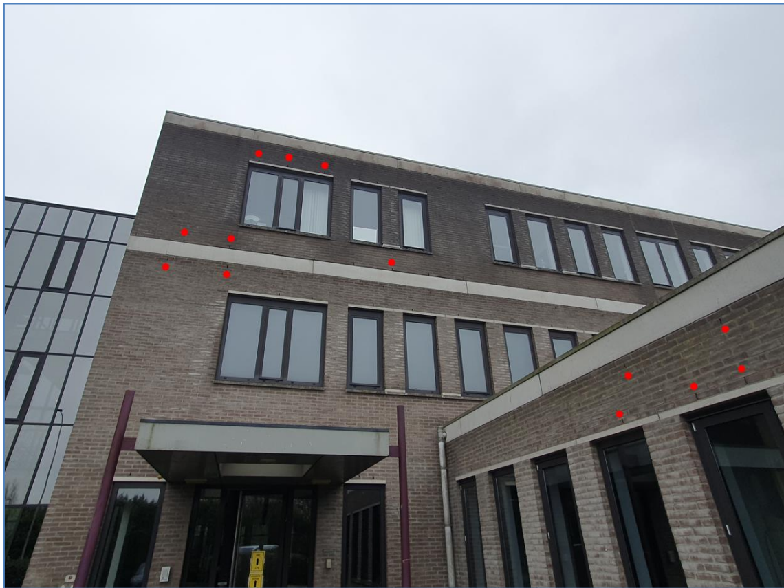
Figuur 25: Gebouw G met een deel van de open stootvoegen bij de rode stippen
