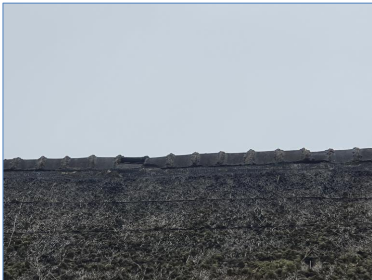
Figuur 18: Er is geen ruimte onder de nokpan noch onder de pannen ernaast
