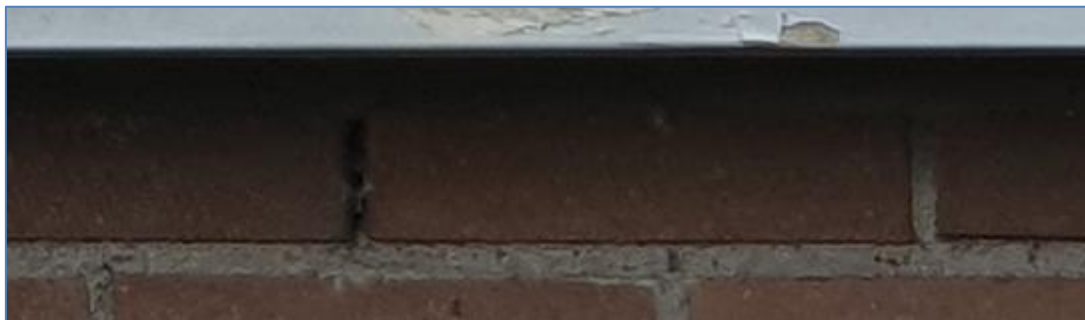
Figuur 22: Open stootvoeg bewoond door een type Trechterspin
