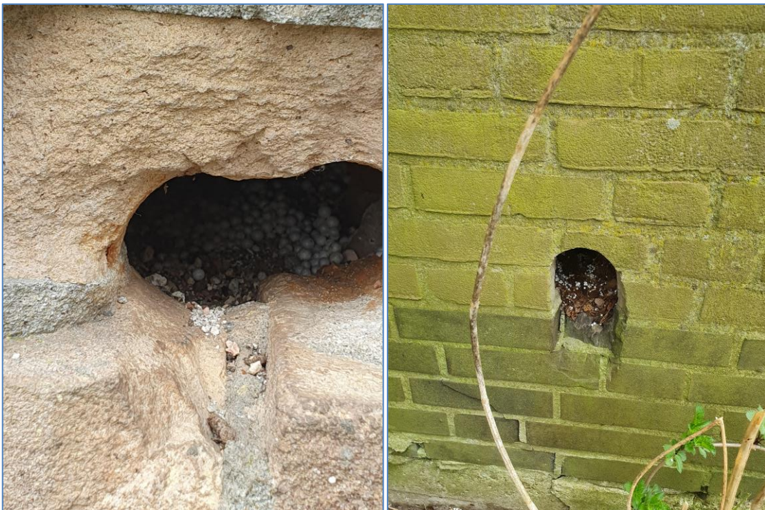
Figuur 9: Zichtbaar is de isolatie van de spouw, deze openingen leiden niet naar een ruimte
