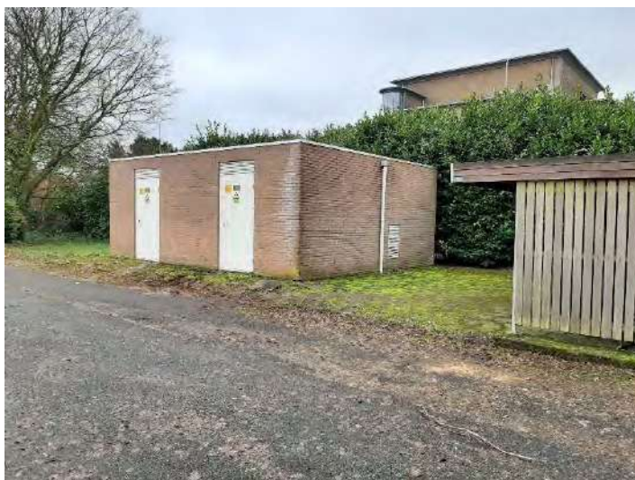
Foto 13: trafohuisje en fietsenstalling
