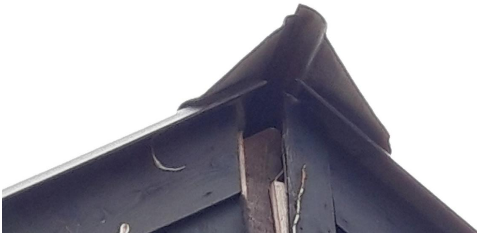
Figuur 5.5: Opening in de nok van een schuur
