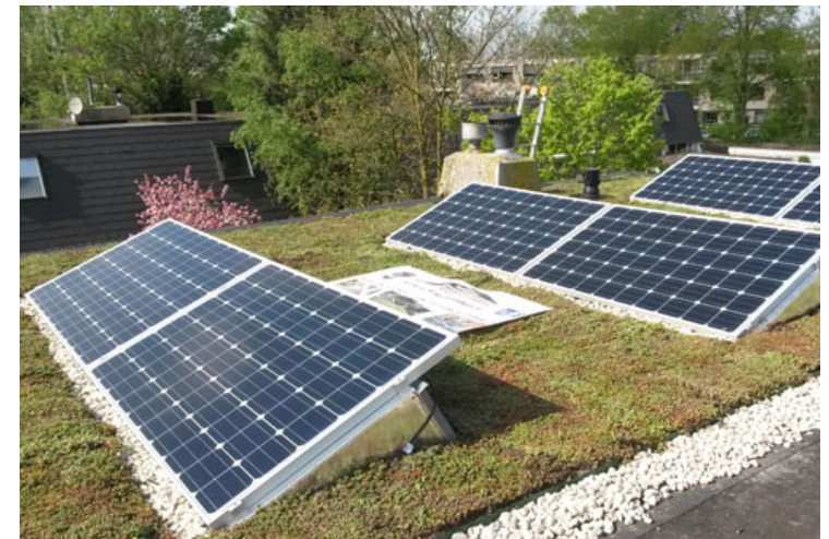
Zonnepanelen op plat groendak
