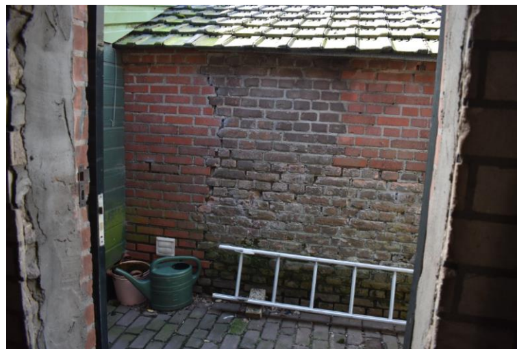
Achtergevel bedrijfsdeel linkerzijde dichtgezet venster en inboetwerk.
