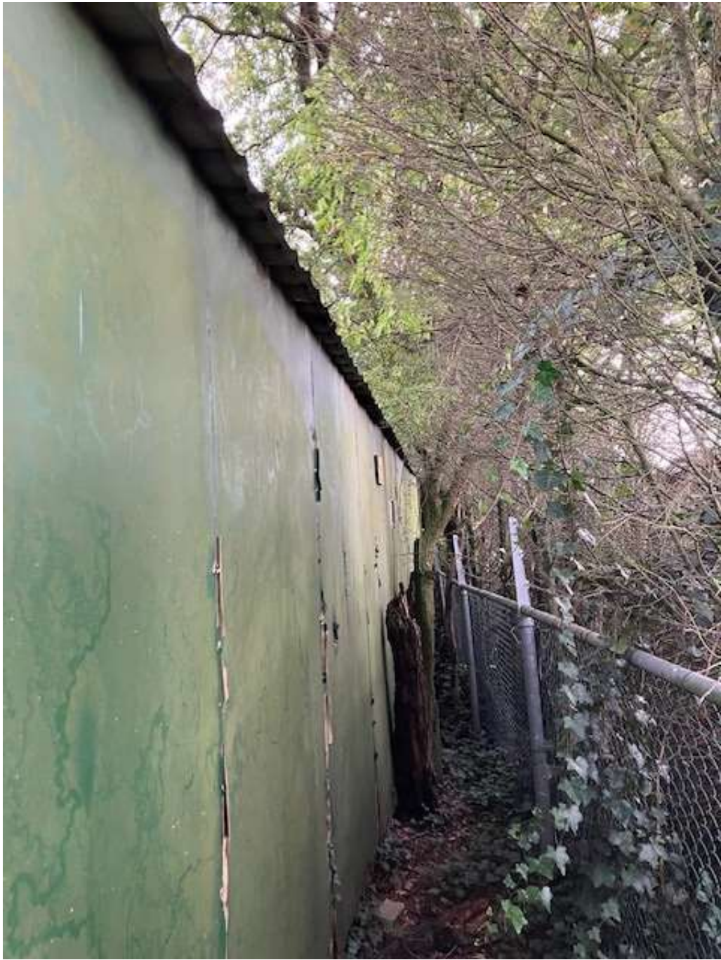
• Afbeelding 19: Achterzijde bijgebouw, gevels rafelen, erfafscheiding is hekwerk met gaas
