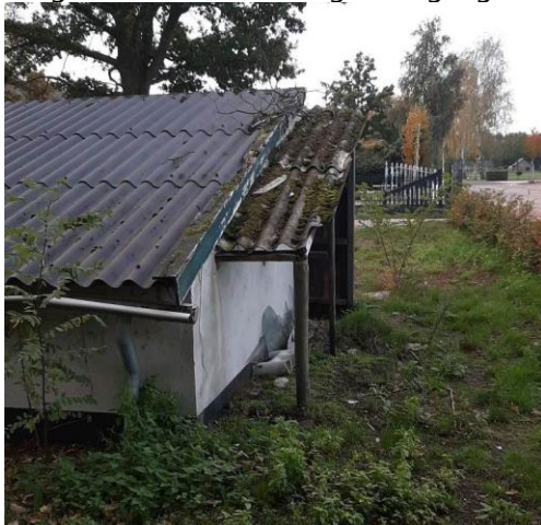
foto 3: Overkapping met asbestverdachte platen
