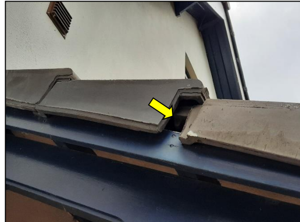
Figuur 10. Ruimte tussen dakpannen.
