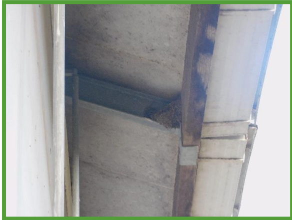
nest van boerenwaluw aangetroffen onder dakoverstek van de te slopen loods
