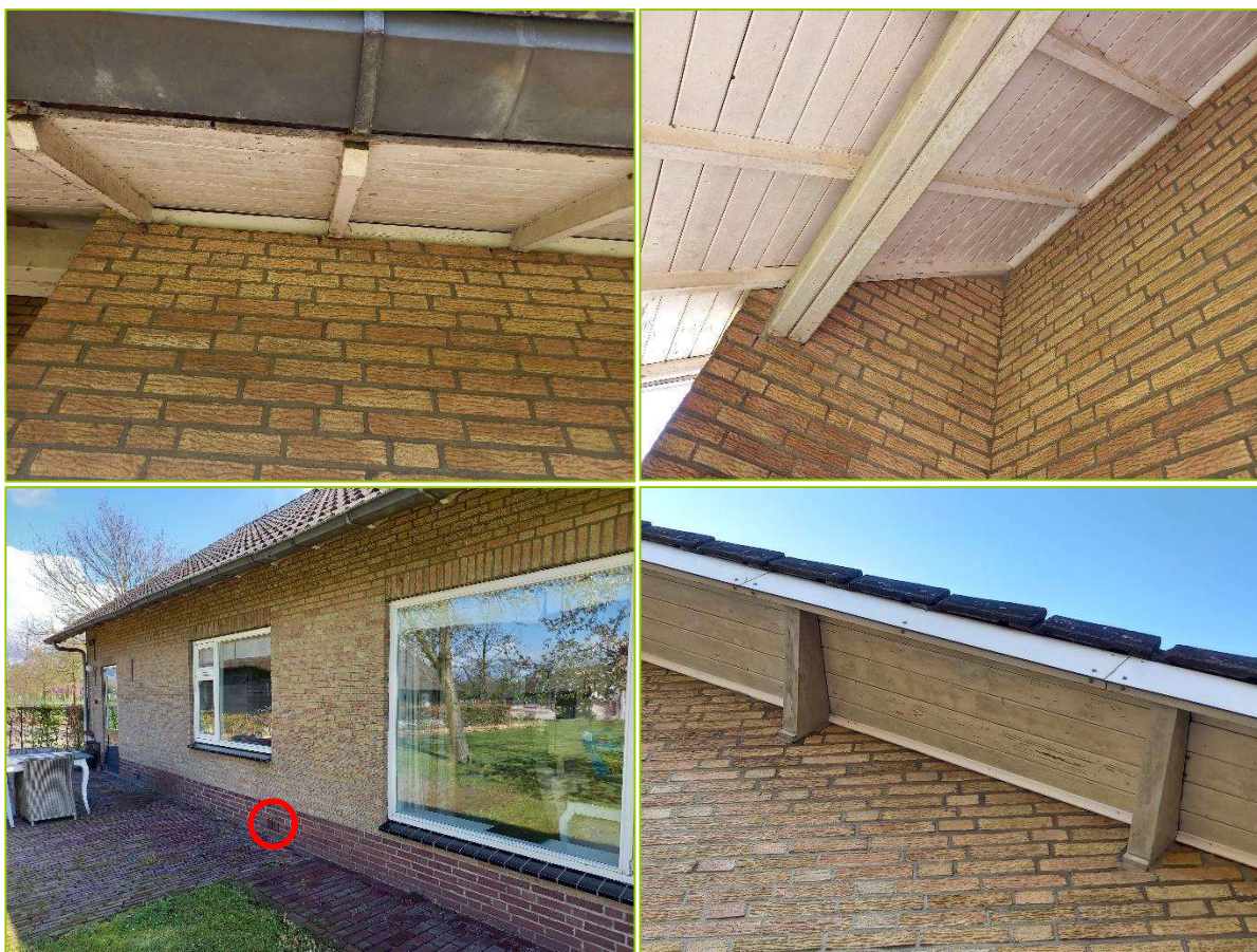
Figuur 2 Details van het te saneren gebouw. Te zien is dat de overstek nauw aansluit op de gevels en dat de dakpannen relatief dicht aansluiten op de overstek, die glad en geverfd is. De aanwezige open stootvoegen bevinden zich te laag bij de grond om voor vleermuizen bereikbaar te zijn (rood omcirkeld). Aangezien het nagenoeg niet mogelijk was een foto te maken van de details onder de kantpannen, is hiervan geen foto opgenomen.
