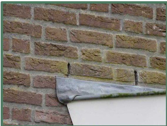
Open stootvoegen bij de bedrijfswoning
