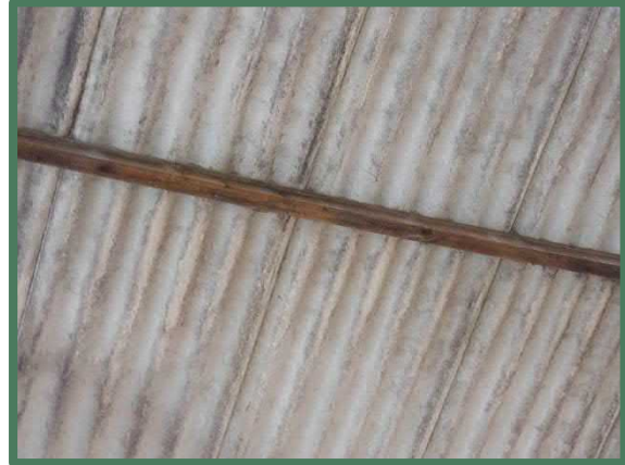
Gebrek aan dakbeschot
