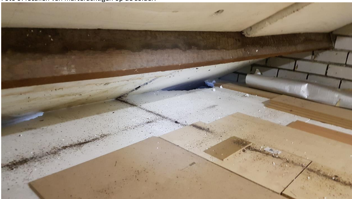
Foto 10: meerdere gaten in het isolatie materiaal op zolder..
