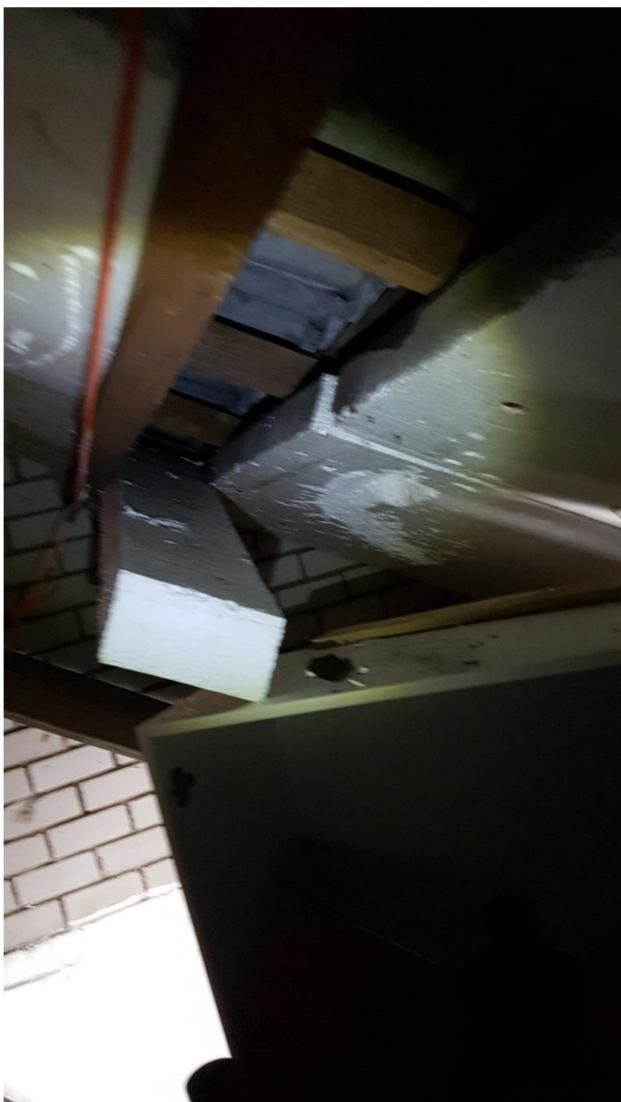
Foto 11: een van de uitgevallen isolatie platen op de zolder.
