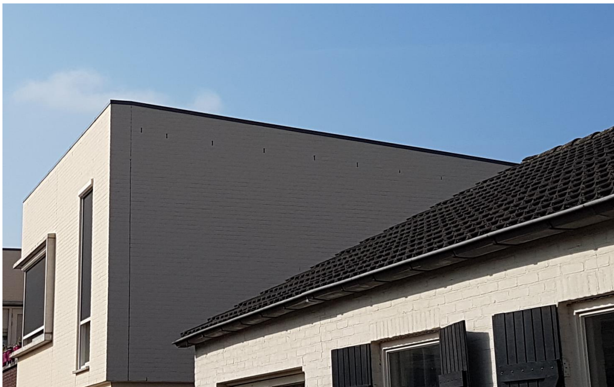
Foto 18: het naburige pande heeft vele open stoot voegen. N.B. gaan de openstootvoegen door aan de straat zijde.
