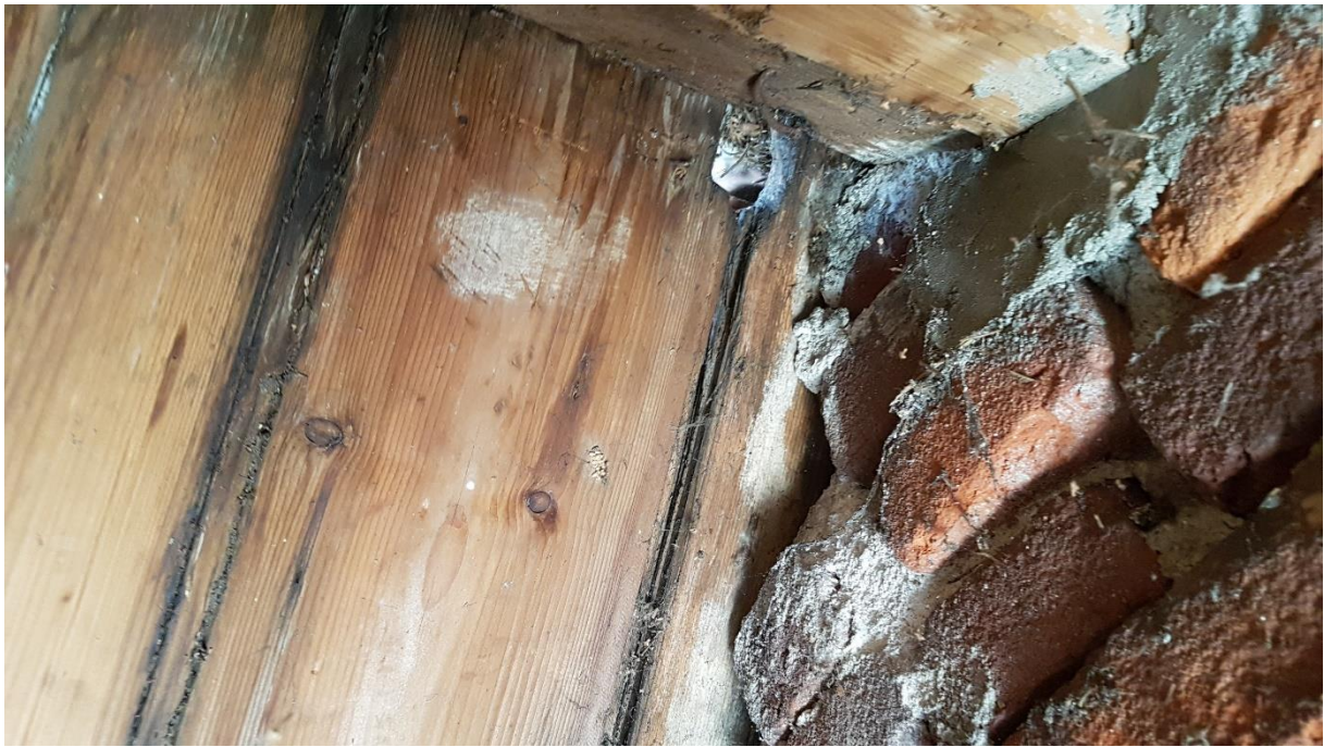
Foto 16: gat ingerot (diameter 1 cm) bij de ontbrekende nokvorst.
