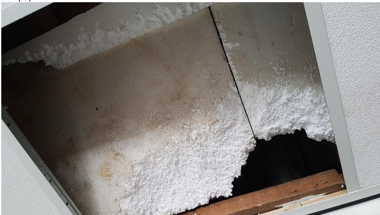
Foto 6: gaten in het isolatie materiaal bij weggevalen plafond plaat.
