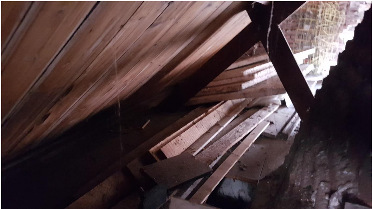
Foto 14: stapel isolatie platen op de zolder waren niet beschadigd.
