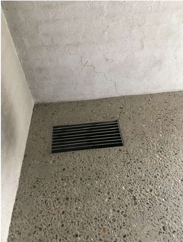
In het hoofdhuis bevinden zich onder de vloer bouwkundige kanalen ten behoeve van de hete-luchtverwarmingssysteem.
