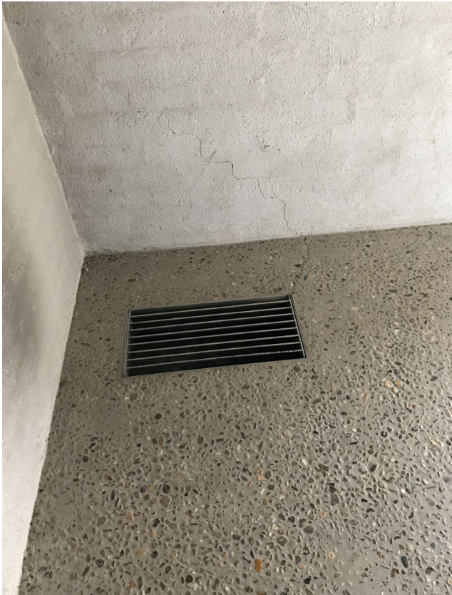
In het hoofdhuis bevinden zich onder de vloer bouwkundige kanalen ten behoeve van de hete-luchtverwarmingssysteem.
