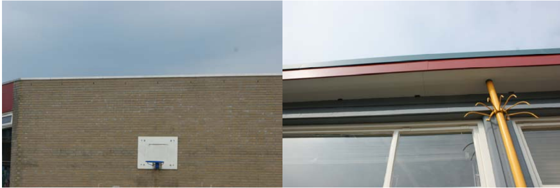
Openstootvoegen in gevel
