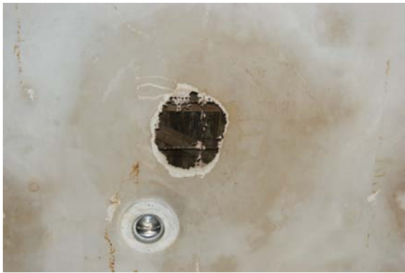
Gat in plafond grote kerkzaal
